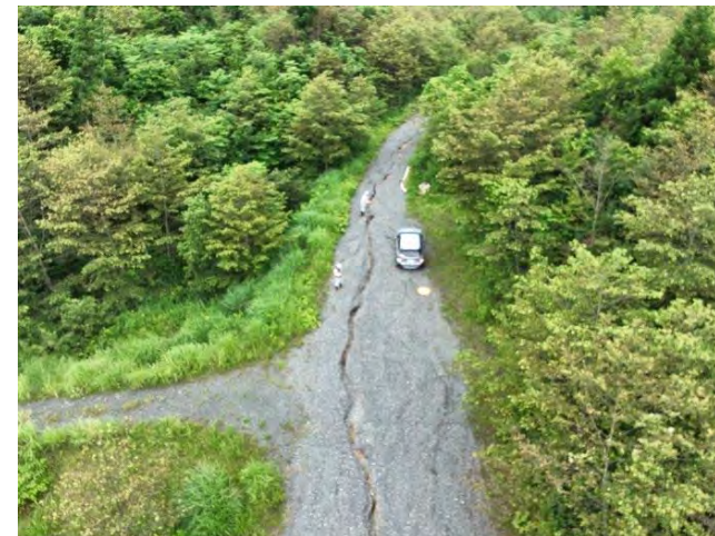
地内の作業道路床の洗掘 車両通行への支障など
