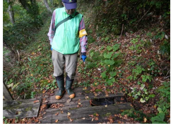
中央散策路メダマ沼の先の橋板が壊れていました
