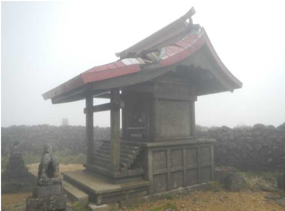
熊野岳神社の屋根が強風でめくれ上がっていました
