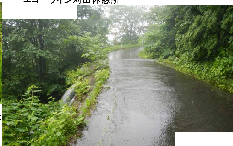
蔵王林道の出水箇所 昼過ぎの強雨の後
