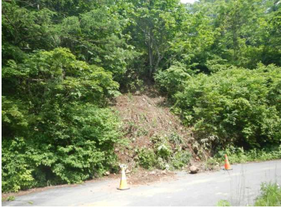
蔵王林道の土砂崩れ現場
