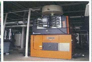
木質バイオマスボイラ
