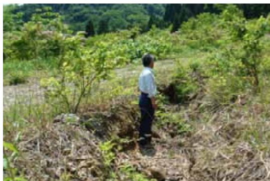
作業道沿い浸食箇所
