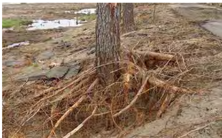
貞山堀堤の下り勾配での侵食（仙台市宮城野区）
