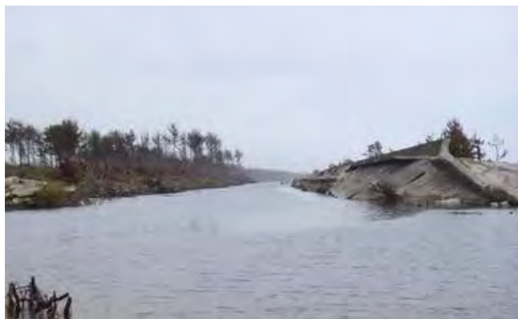
防潮堤内陸側の侵食（亘理町）
