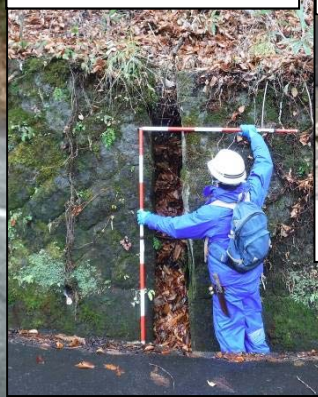
国道103号 擁壁隙間
