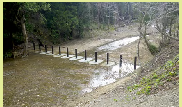
流木対策(独立基礎型流木捕捉工) 流木を補足することにより下流や溪畔林への流木被害を防止する(青森森林管理署：青森県外ヶ浜町)
