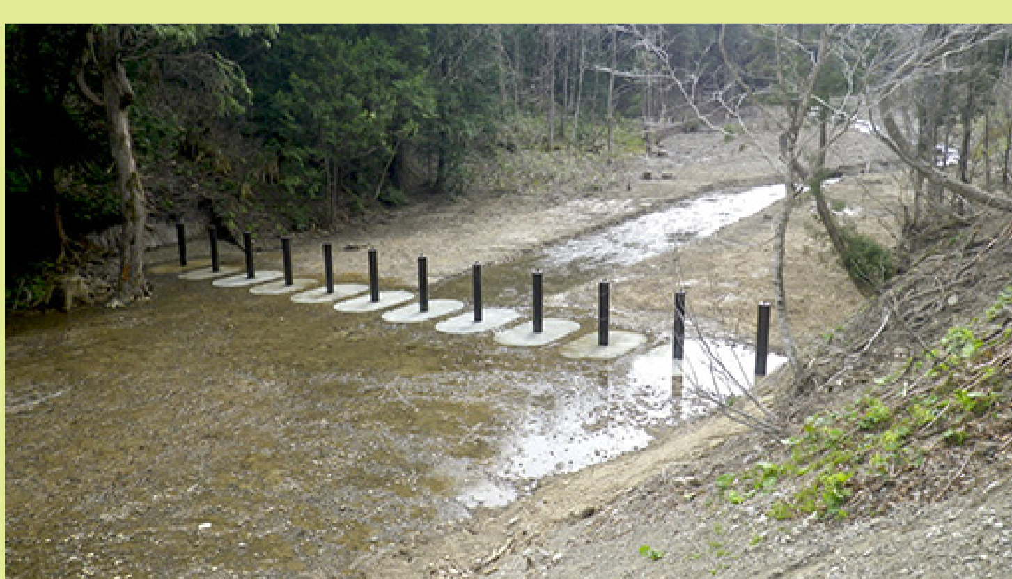
流木対策 (独立基礎型流木捕捉工) 流木を補足することにより下流や溪畔林への流木被害を防止する (青森森林管理署：青森県外ヶ浜町)
