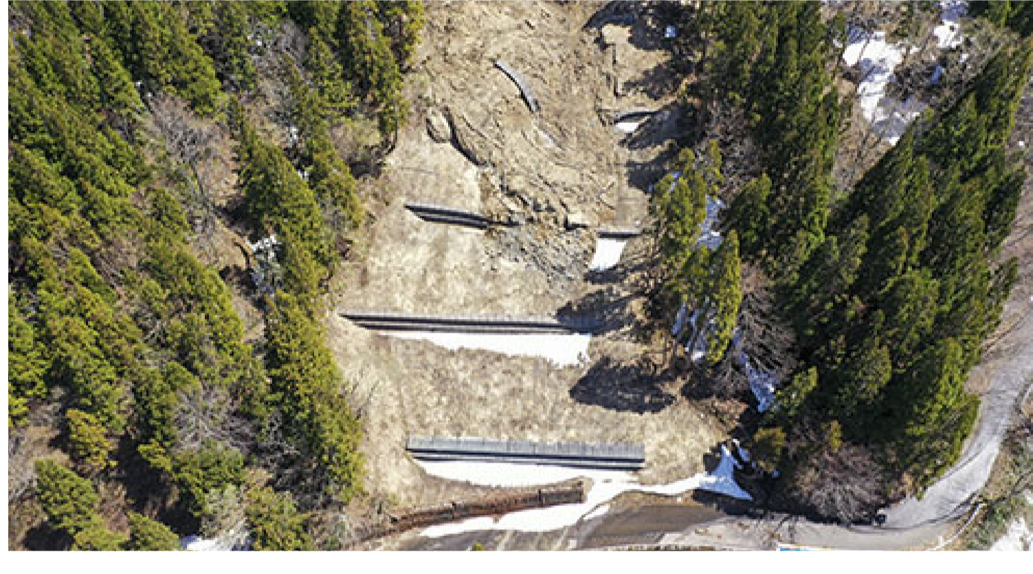
融雪出水に伴う土砂崩れが発生し、治山施設に被害
