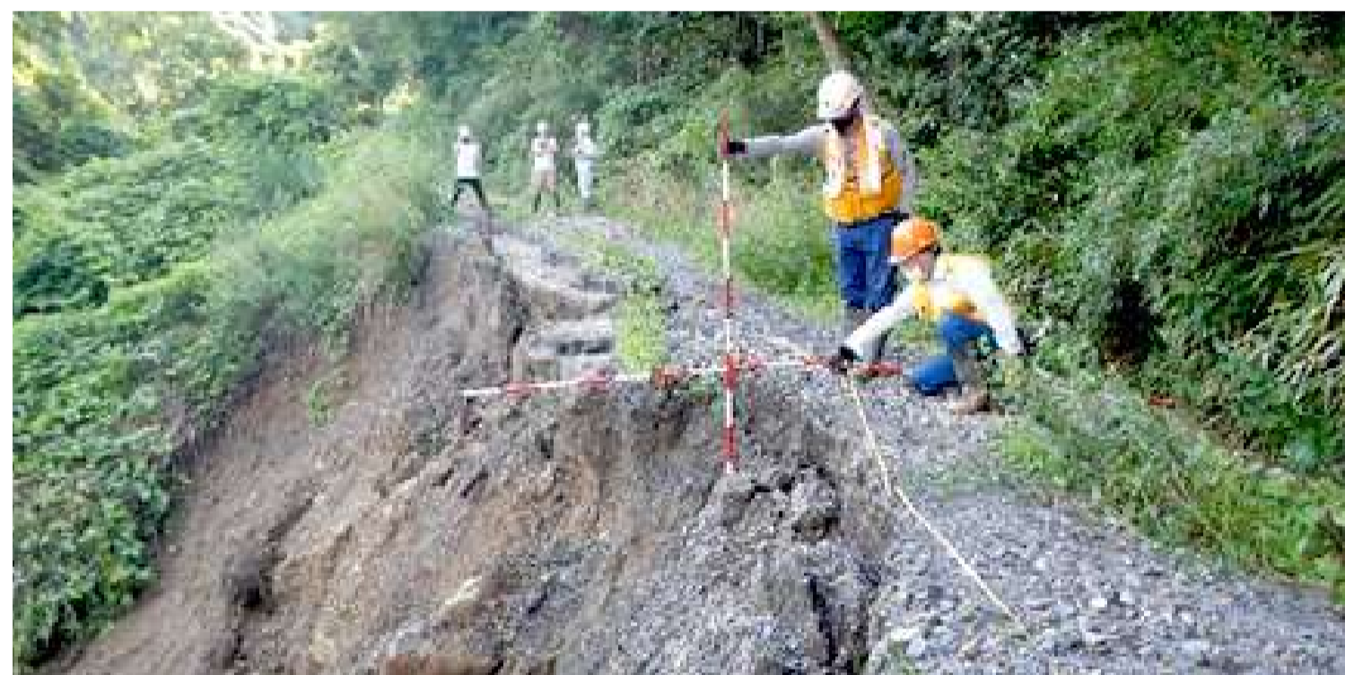
令和4年7月豪雨における被害状況調査
