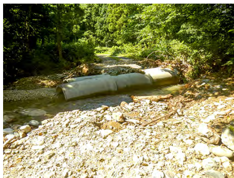
林道被害状況
