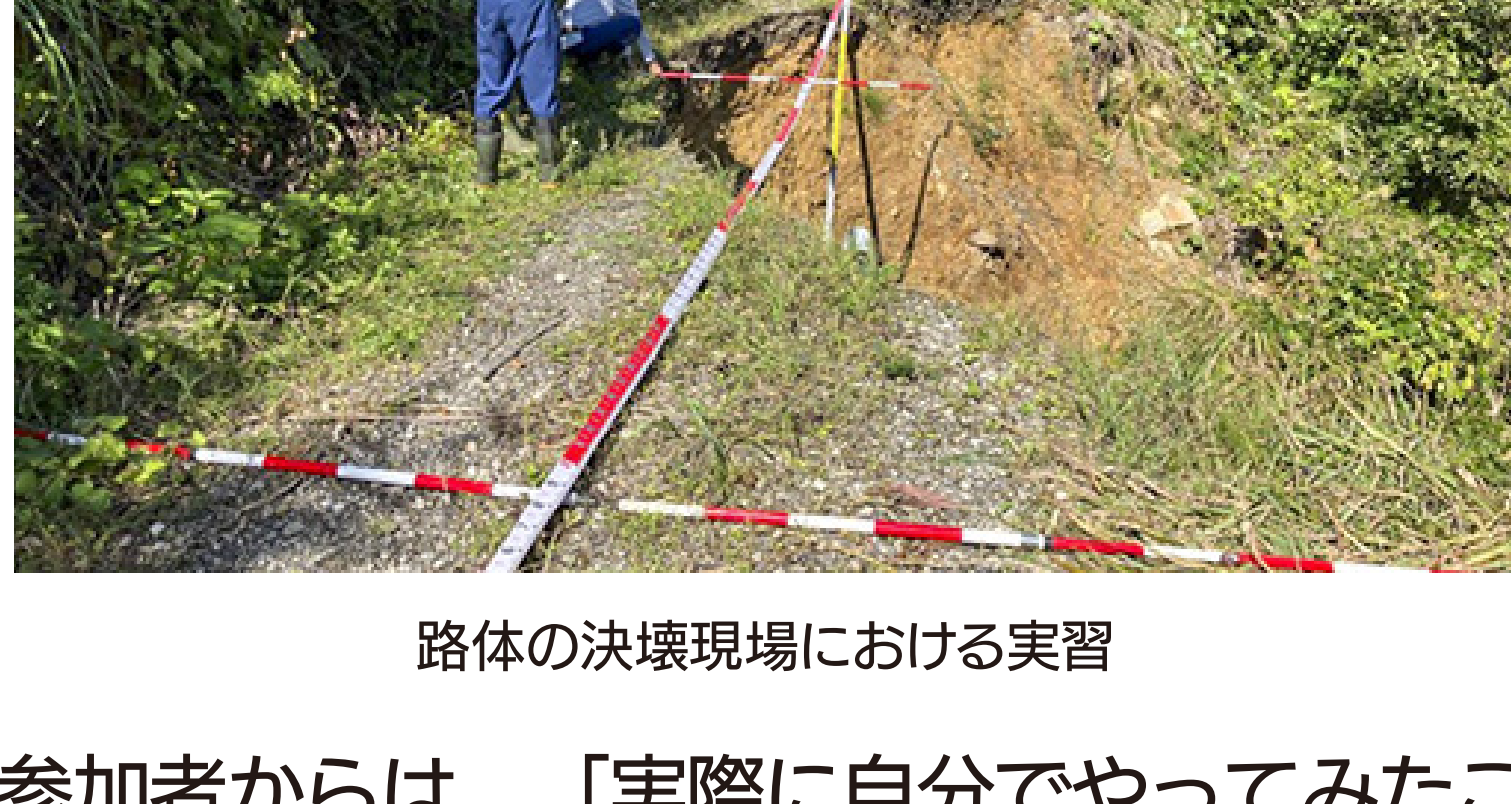
路体の決壊現場における実習
