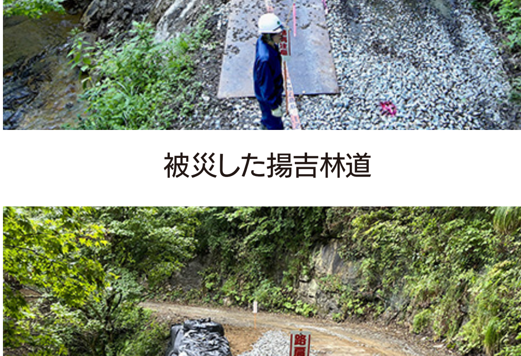
被災した揚吉林道
