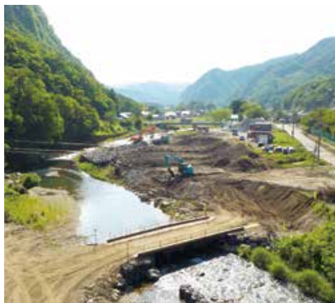
復旧が進む安家川
