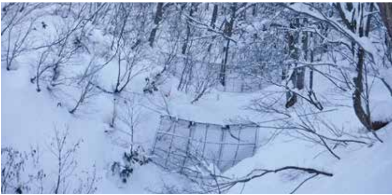
写真6 整備したなだれ予防ネット
