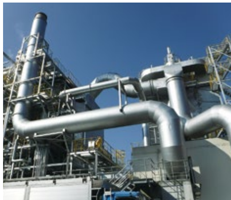
バイオオマズ発電所全景
