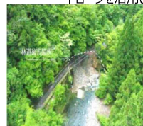
林道被災箇所全体の撮影(安芸署)
