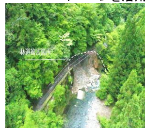
林道被災箇所全体の撮影(安芸署)
