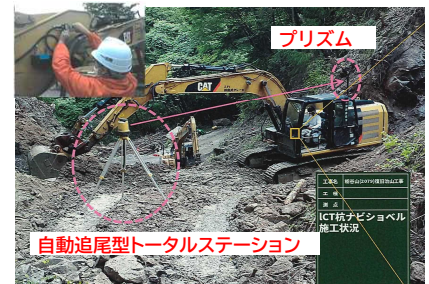
ICT掘削実行中 （栃谷山（2079）復旧治山工事） 高知県北川村：安芸署
