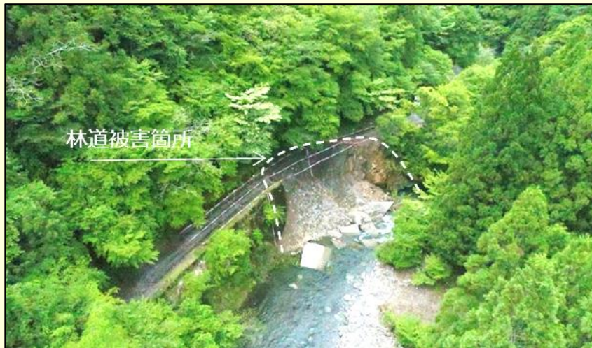
被災箇所全体を1枚の写真で撮影可能
