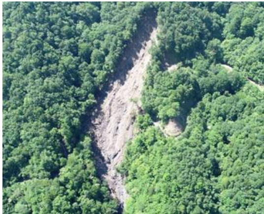
ドローンによる上空からの撮影により、全体の被害状況の確認が可能。
