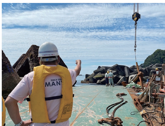
船に乗って市内漁港の工事の立会に同行することもある
