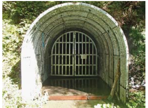
地下水を排除するための排水トンネル
