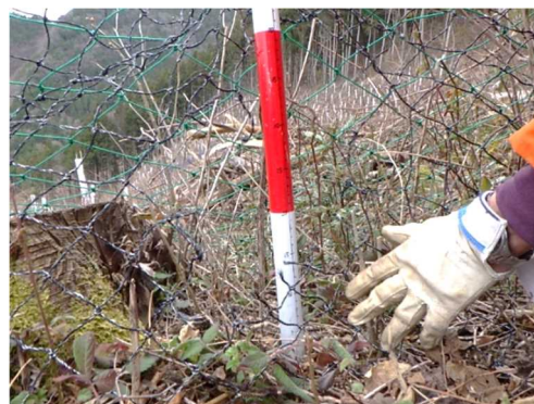
写真6 タイプD本体ネットの破損
