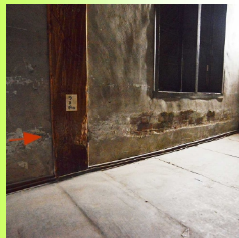
写真1: 旧富岡製糸場西置繭所に残る作業台車等による傷痕（赤矢印の高さの傷）
