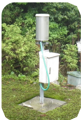
雨量測定装置
