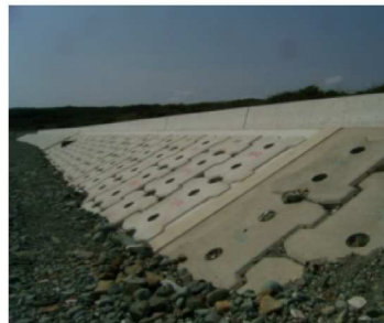
陸域の浸食の防止・固定を図る護岸工
