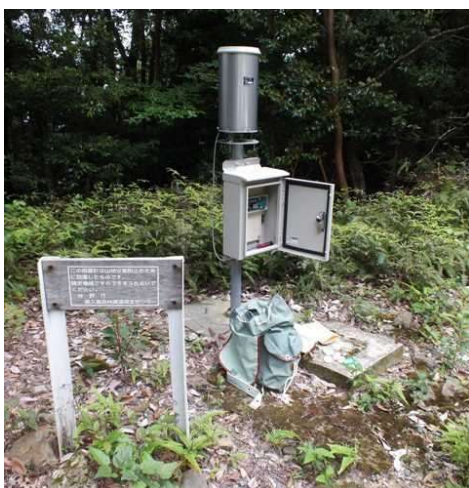
写真3-1. 観測機器(雨量計)
