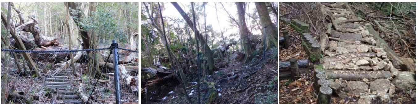
迂回歩道からの風景(防護柵越し)（左）、既設歩道からの風景(折損部望む)（中）、 新設歩道迂回路(近自然工法)（右）
