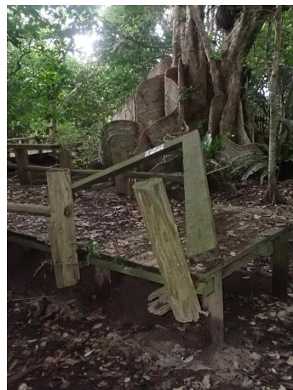
（写真 19）倒壊した木道デッキ
