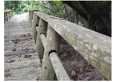
【写真10 連絡道の手摺り(傾いている)】
