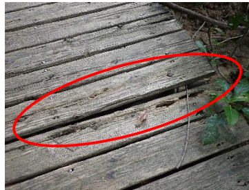
【写真9 腐朽が著しい連絡道床板(赤丸)】
