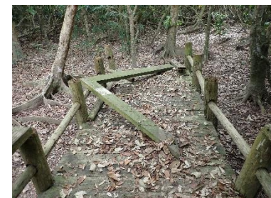
【写真12 台風被害により壊れた手摺り等(BM2付近)】
