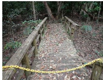
【写真11 台風被害により壊れた手摺り等(BM1付近)】
