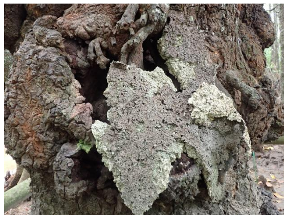
【写真5 浮かび上がった充填物】
