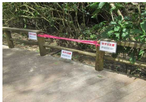
写真 13 損傷を受けた木道
