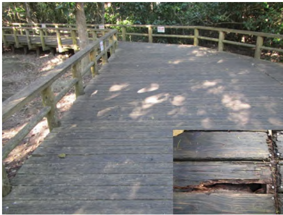
写真4 修繕前の観察デッキ
