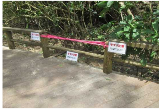
写真3 損傷を受けた木道
