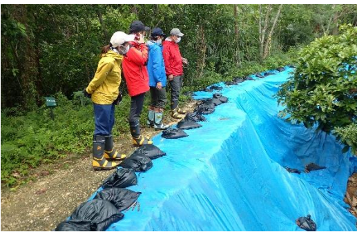
【伊藤署長から台風12号災害箇所の説明を受ける矢野局長（右奥）及び局職員】
