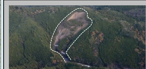
⑥八升前区域（田辺市本宮町湯峯） ・崩壊規模 1.55ha ・対策工：溪間工 山腹工 ※事業完了 移管済み
