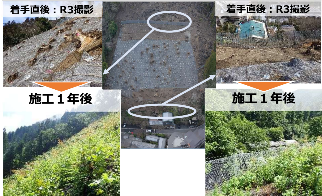
▲【京都府京都市 貴船山国有林：斜面安定対策工施工(経過)状況】 （京都大阪森林管理事務所）
