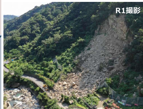
▲ 【R1.7被災の斜面崩壊地】 （上秋津区域）
