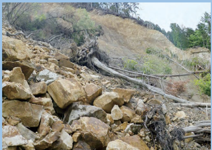
脆い岩などが豪雨時に崩落した様子（上平治川区域）
