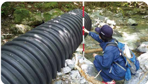
林業専用道崩壊箇所の調査。川の水を通していたコルゲート管の大きさを測っている様子。
