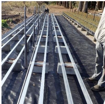
コンテナ設置台
