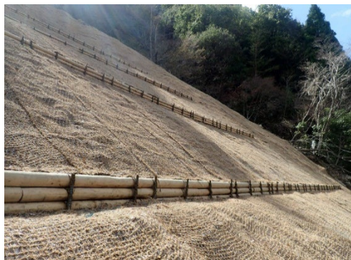
丸太筋工(0.2m 3 /m) 山腹斜面の雨水の分散と 地表侵食の防止のため施工
