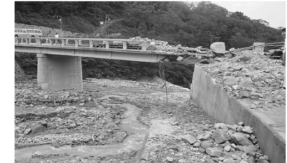
大山からの土砂生産に起因した土石流災害
