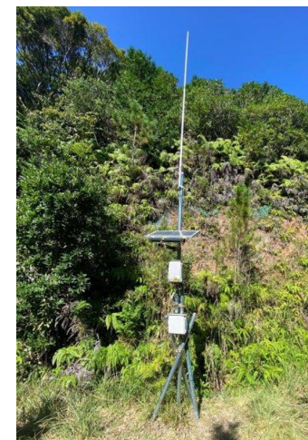
親機の設置状況
