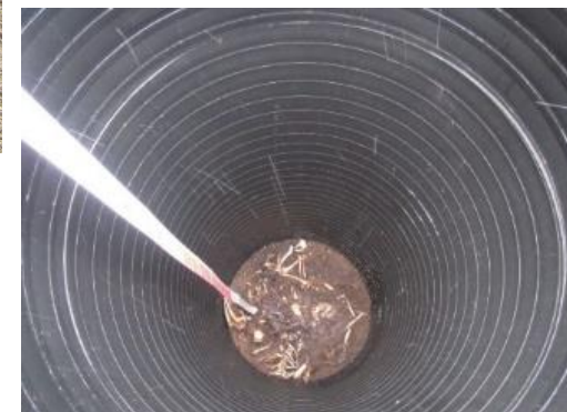
埋設した大型排水管 (内部)
