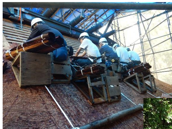
左：檜皮による屋根の葺き替え作業 (全国社寺屋根工事技術保存会提供)
