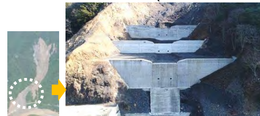
【被災直後の状況】
